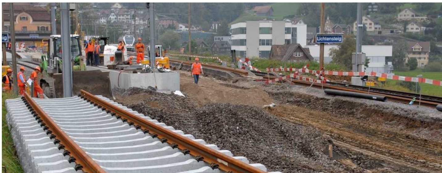
Am Bahnhof Lichtensteig finden Bauarbeiten statt, um das öV-Angebot zu verbessern, Foto: Manuela Matt
